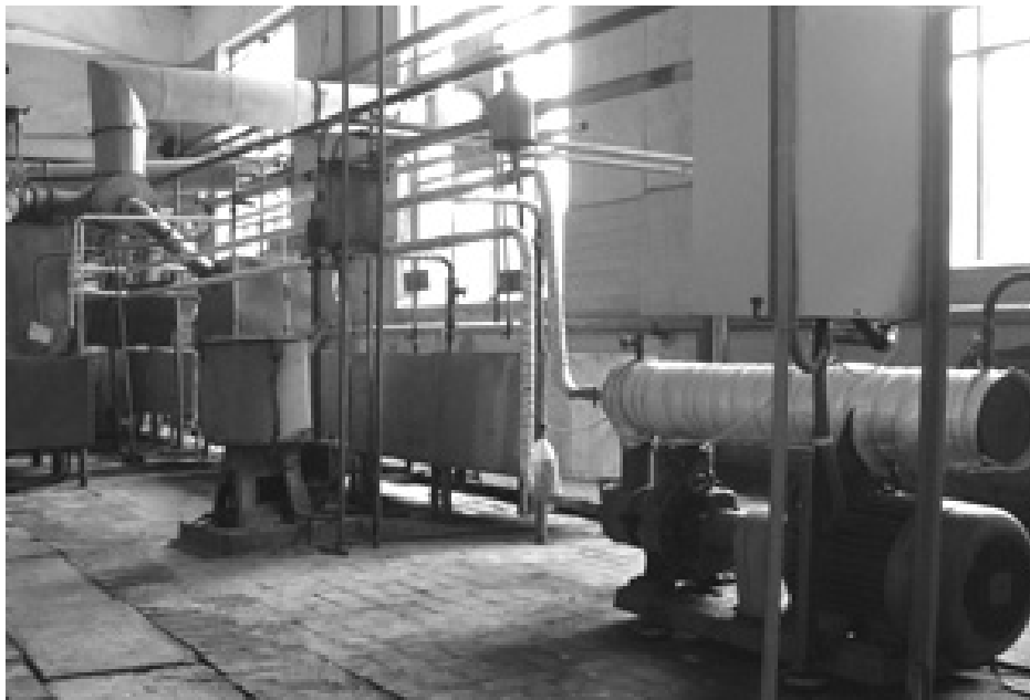
Рис. 4 Вихревой теплогенератор обеспечивает автономное теплоснабжение гальванических ванн
